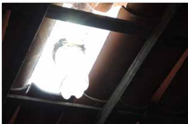
Considerável ganho de iluminação (Caucaia)
